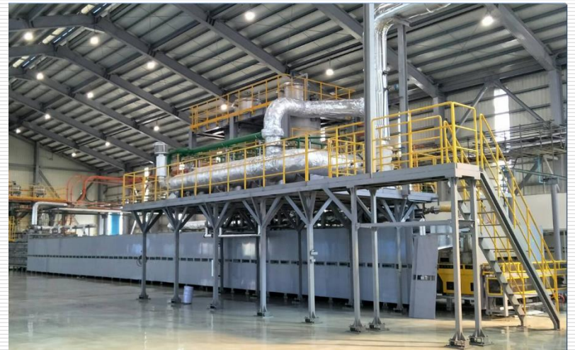
碳化爐產線(2,000噸/年)
